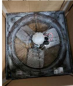
Old exhaust fan
