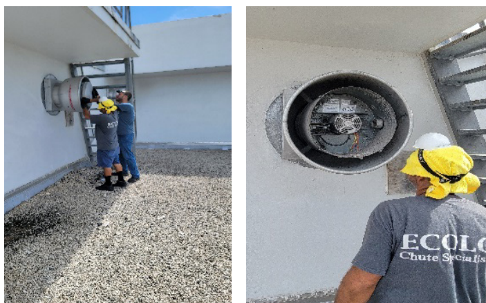
Roof - laundry exhaust fan
